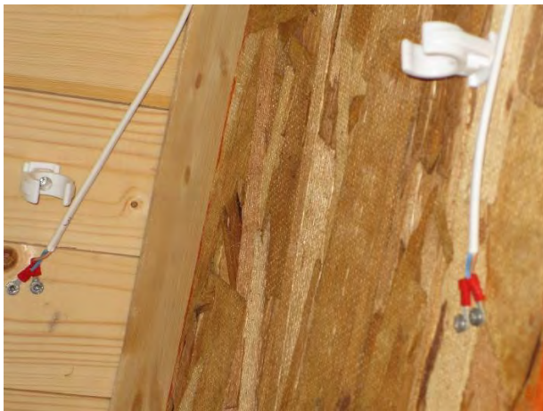
Følere er monteret mange steder i konstruktionen
